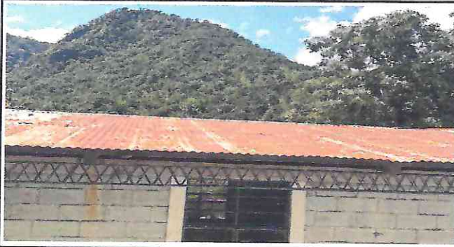
Foto 1: Se muestra el estado de la lamina de todas las aulas.
