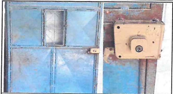
Foto 2: Puertas de metal en mal estado y chapas inservibles.
